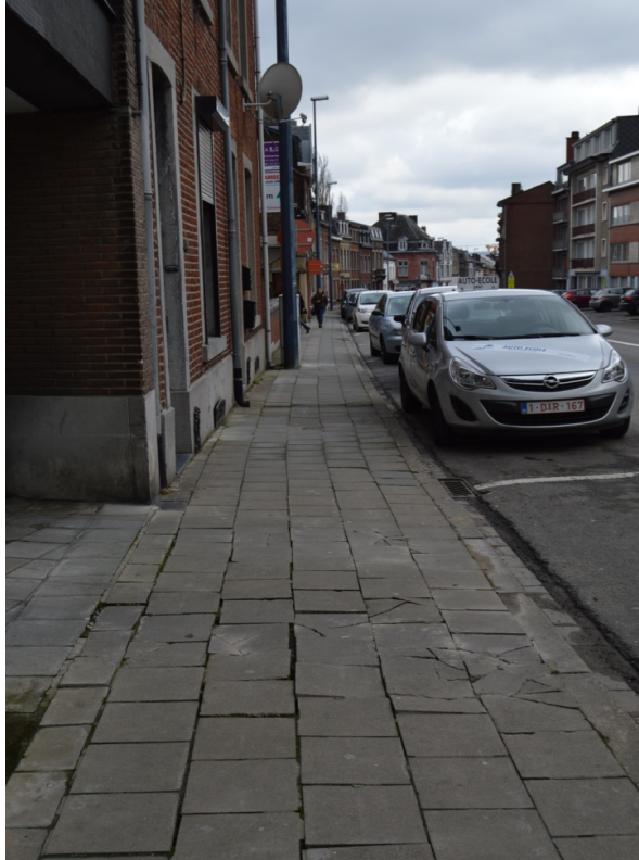
Trottoir en mauvais état
